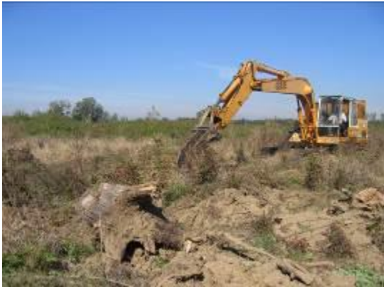
Προετοιμασία για τις φυτεύσεις: απομάκρυνση κορμών λέυκης (Φωτογραφία Δ/νση Δασών Καβάλας / Δημήτρης Φιλιάδης)
