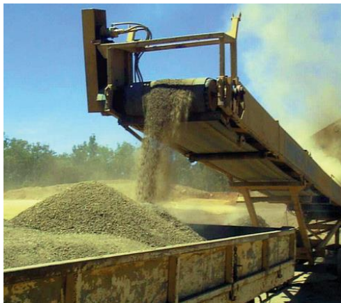
La couche arable est projetée pour obtenir un mélange riche utilisé pour maximiser la croissance des semences dans les zones restaurées (Auteur: Alcoa World Alumina Australia ©)
